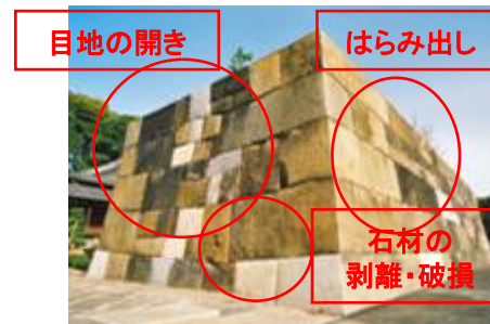
修復前(石垣の変形状況)
